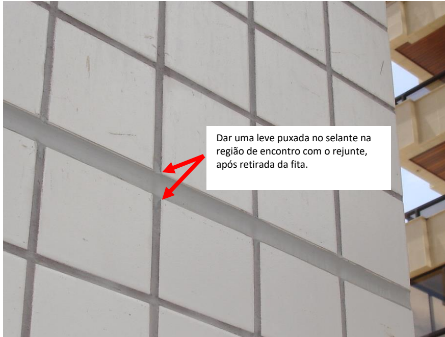
Figura 6 – Exemplo da leve puxada do selante no encontro com o rejunte para evitar infiltração.
