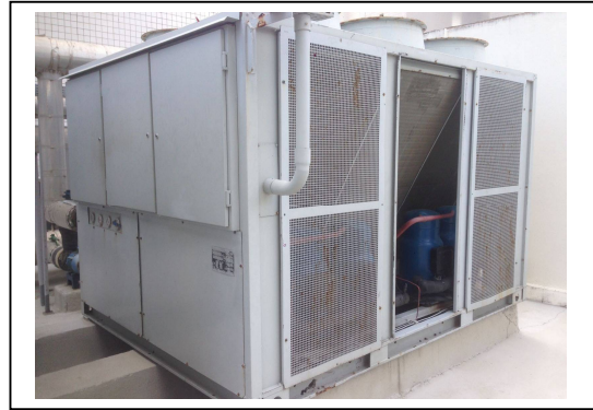
FOTO 02: Vista Parcial CHILLER
