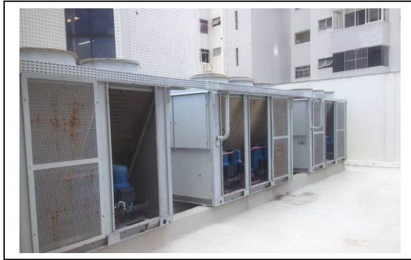
FOTO 01: Vista Parcial CHILLER
